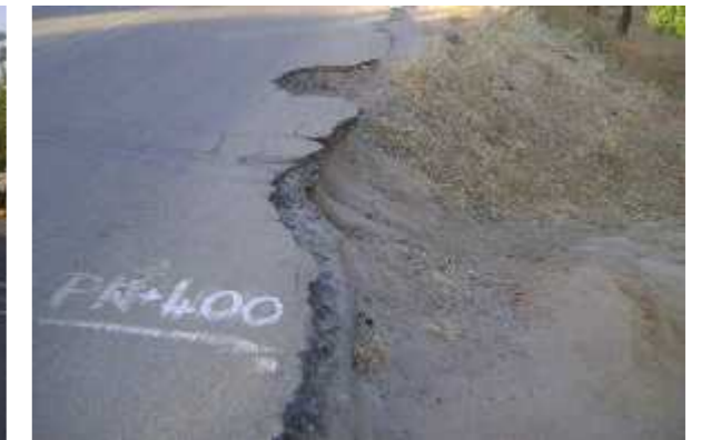
Epaufures de bords de chaussée au niveau d'un accès créé par les motos taxi et piétons au niveau du talus
