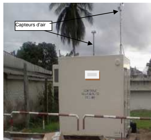
Cabine installée par Egis pour analyse en continue de la qualité de l'air chez un particulier Camerounais : la cabine est équipée de capteurs d'air dont les extrémités sont visibles au dessus.
