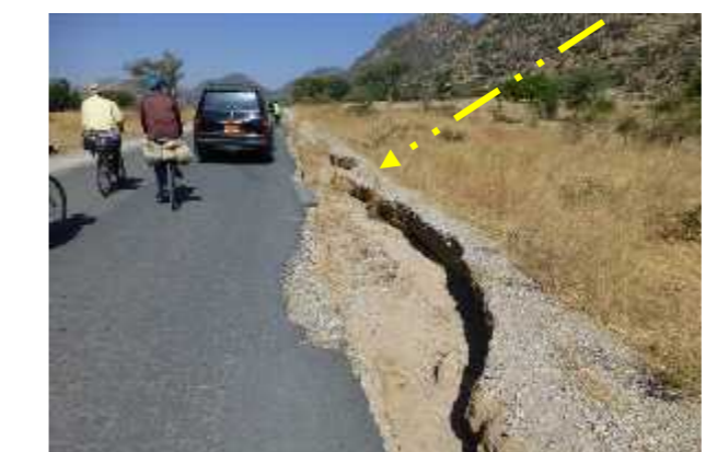
Pk 19+300 TCHERE : Rigole créée par les eaux de ruissellement en provenance du sommet des montagnes : fossés à prévoir
