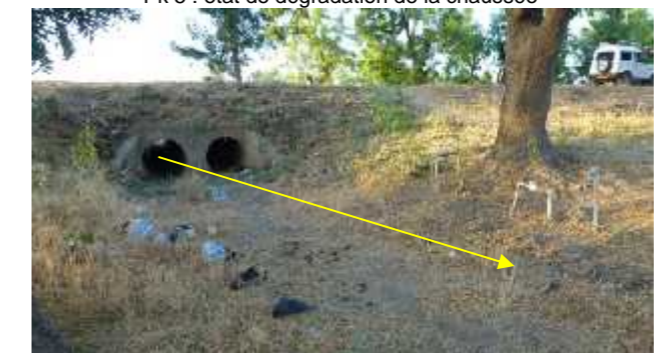
Buse renvoyant les eaux vers des zones habitées
