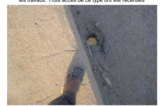
Barbacane percée à travers le tablier au Pont Kaliao et débouchant directement dans le lit de la rivière
