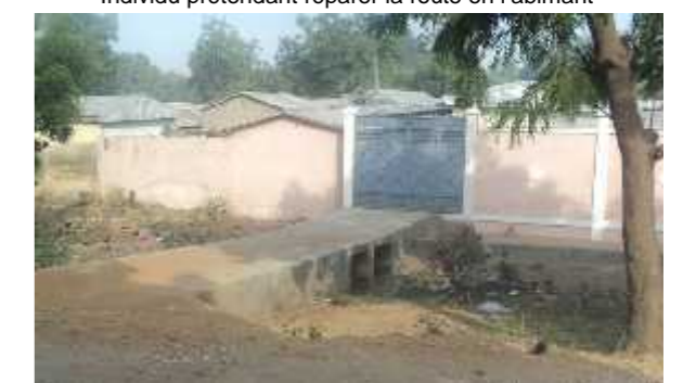
Pk 3+100. Accès riverain susceptible d'être endommagé par les travaux. Trois accès de ce type ont été recensés
