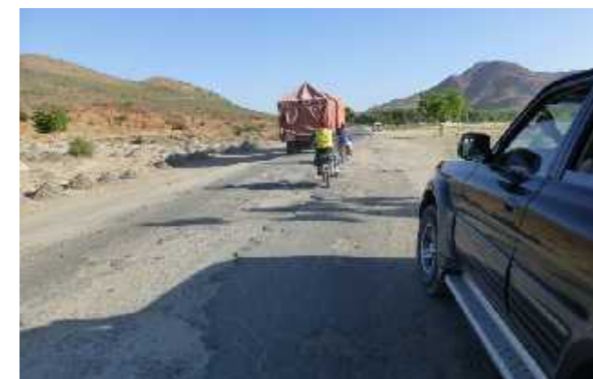
Pk 5 : état de dégradation de la chaussée
